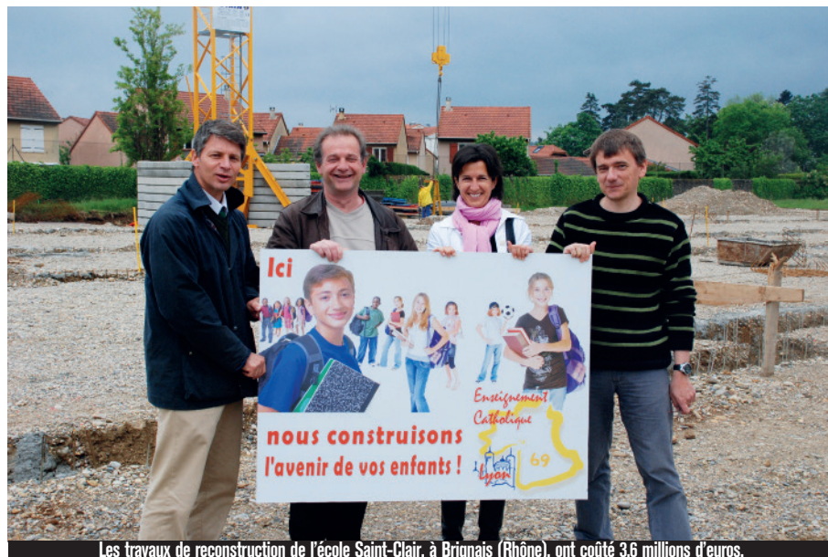
Les travaux de reconstruction de l'école Saint-Clair, à Brignais (Rhône), ont coûté 3,6 millions d'euros.
